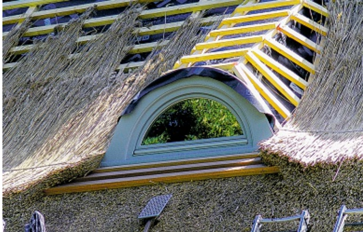
Reetdachsanieierung bei Volker Todt in Schwabstedt. Auch Fenster und Türen wurden erneuert. Das Wohnhaus wurde 1850 erbaut. Foto: Volker Todt
